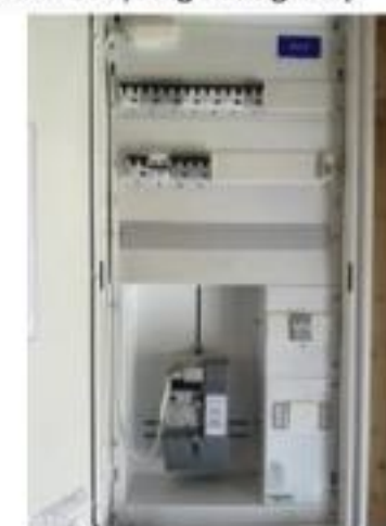
Ryddig og oversiktlig i sikringsskap.
