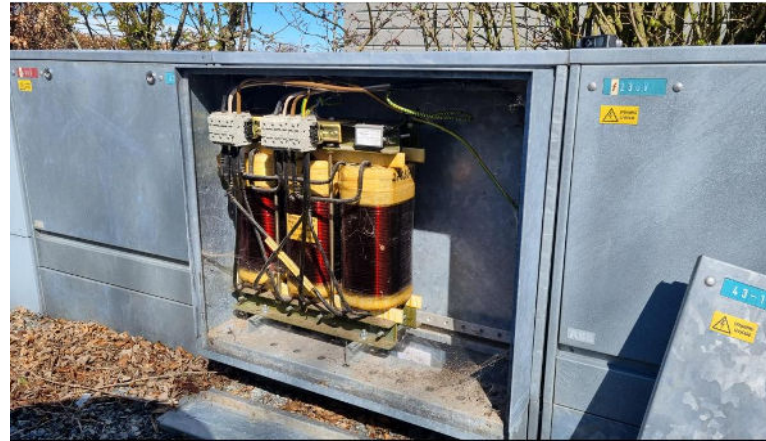
Bilde over viser 40kVA trafoen inni ABB-skap Kabelskap og overganstrafo er til gjenbruk mange gangar framover.
