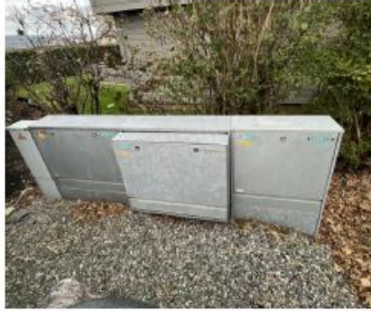
Bildet viser 400V skapet lengst til venstre - Overgangstrafo skapet i midten m/40 kVA trafo Og 230 V skapet lengst til høgre i bilde
