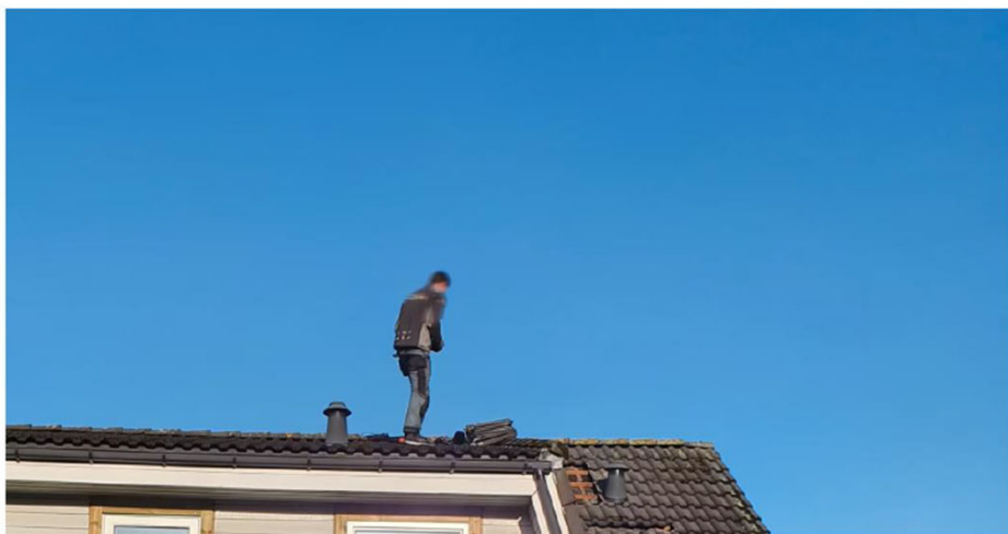
Fra husmønet og ned er det over 9 meter. Her jobbet arbeideren uten sikring. A-krim
